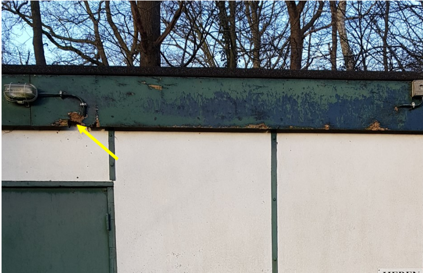
Figuur 5. Voorbeeld van een potentiële invliegopening zoals aangetroffen langs de dakrand van het toiletgebouw (gele pijl).
