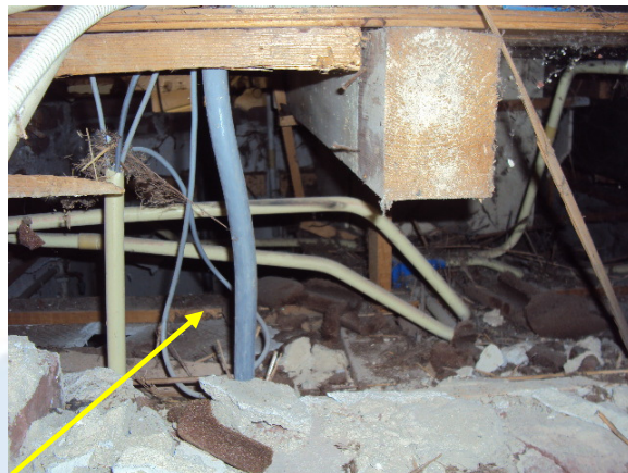
Afbeelding 2: Binnenzijde slaaphuis 4/Beschadigd plafond cv-ruimte
