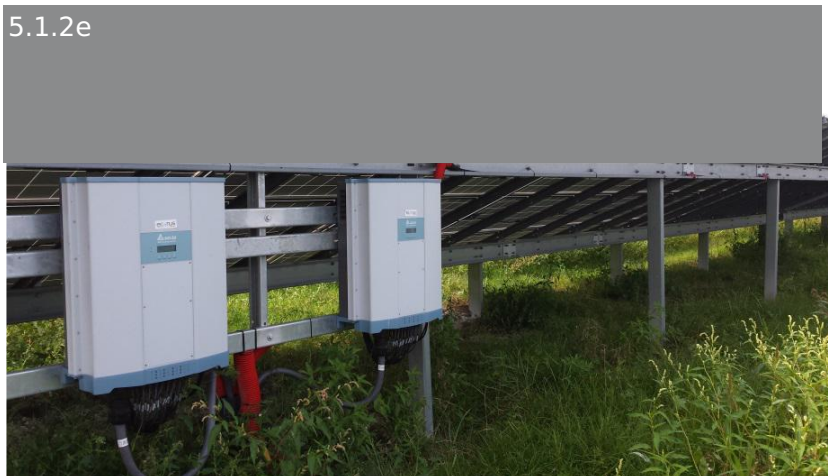
Figuur 12. Twee omvormers in een zonnepark
