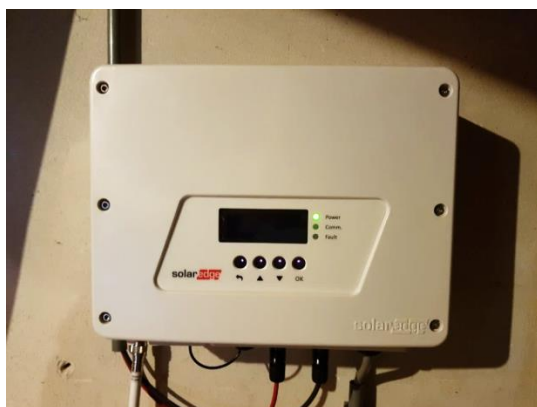
Figuur 10. Omvormer in een woning
